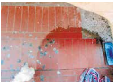
Der Klinkerboden leidet unter den Kaugummiresten.
