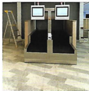
Auf dem neuverlegten Granitboden im Flughafen Helsinki führte tief eingedrungenes Maschinenöl zu Verfärbungen. Fotos: Finalit
