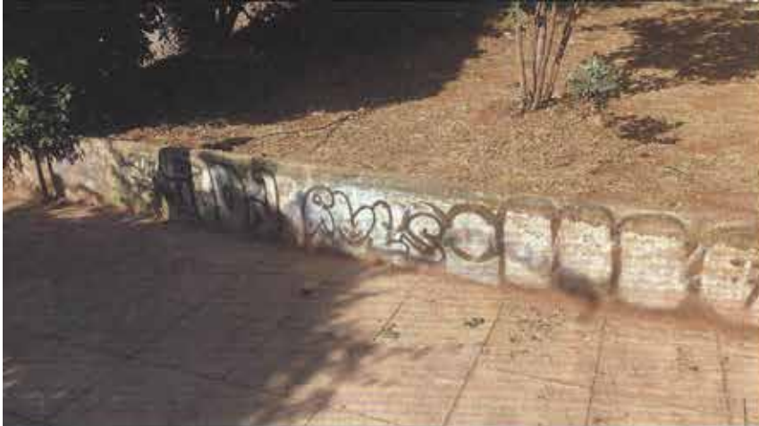
Vorher, im Frühling 2018: Schmierereien wie auf dieser Mauer finden sich überall auf Mauern, Bänken und Säulen der Anlage
