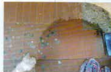
KAUGUMMI. Entfernung auf Klinkerboden
