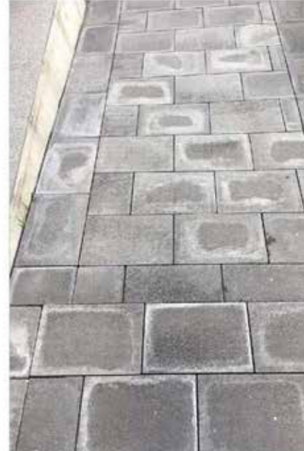
Außenanlage mit Kalkausblühungen.
